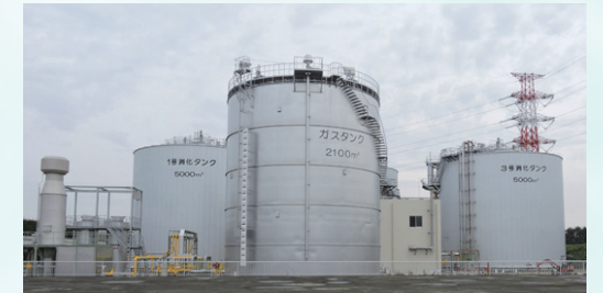
▲ 消化タンク・ガスタンク
